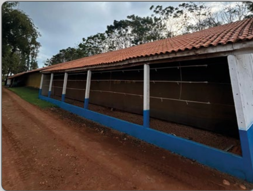
Figura 37 – Aviário pressão negativa convencional.
