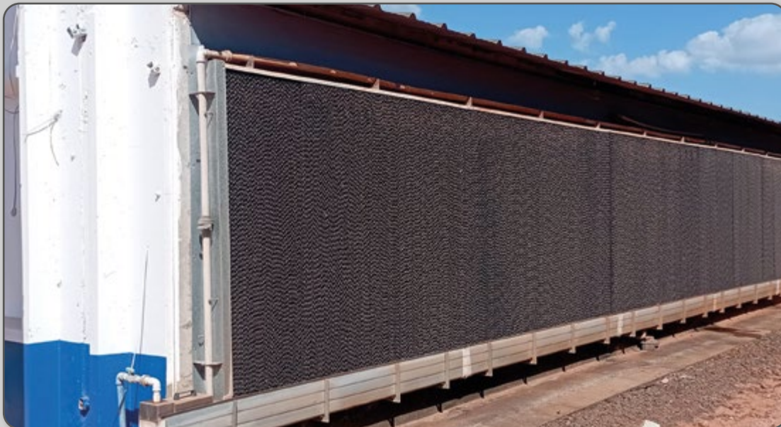
Figura 70 – Entrada de ar com placa evaporativa.
