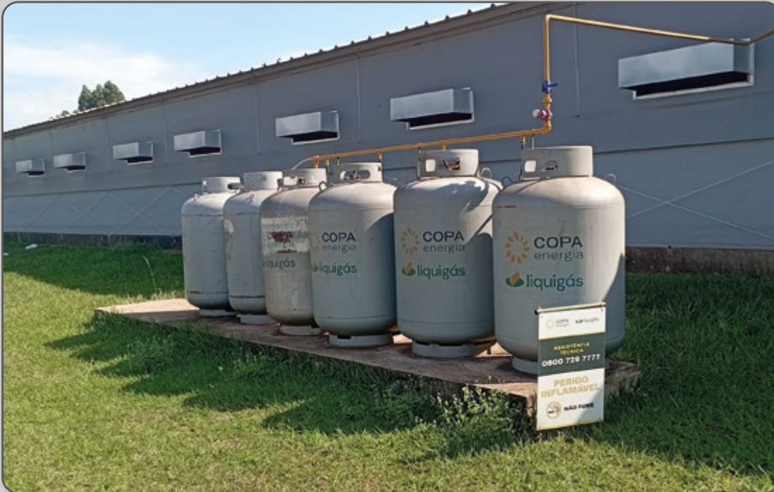
Figura 67 – Reservatório de gás.
