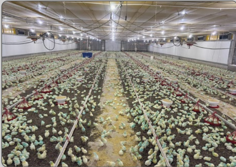
Figura 60 – Aves submetidas à ventilação mínima. Campânulas acesas, inlets abertos.
