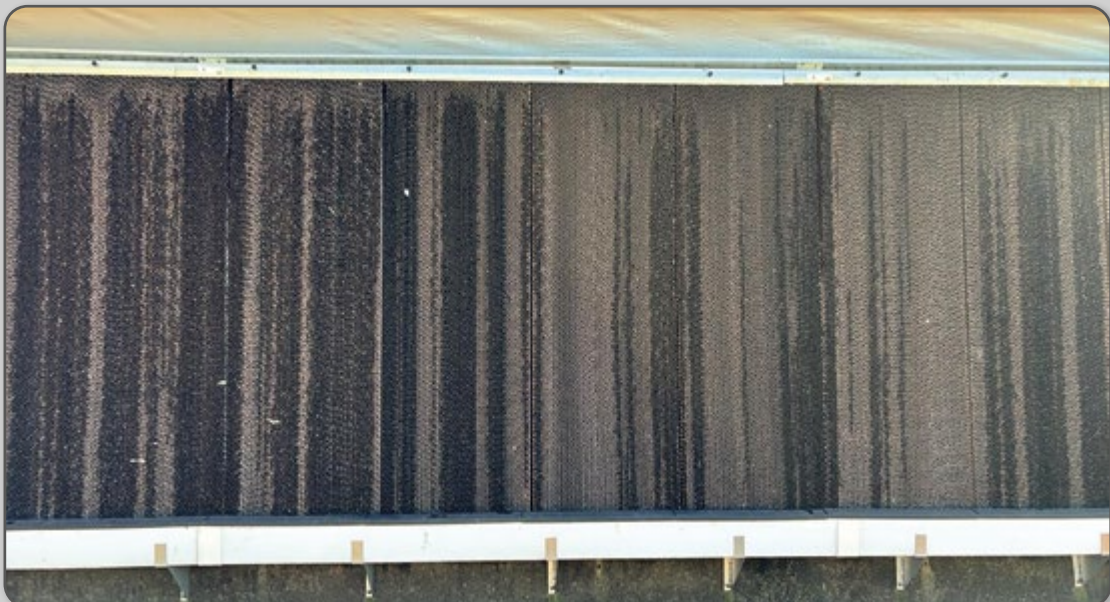
Figura 72 – Sistema de irrigação da placa evaporativa entupido.
