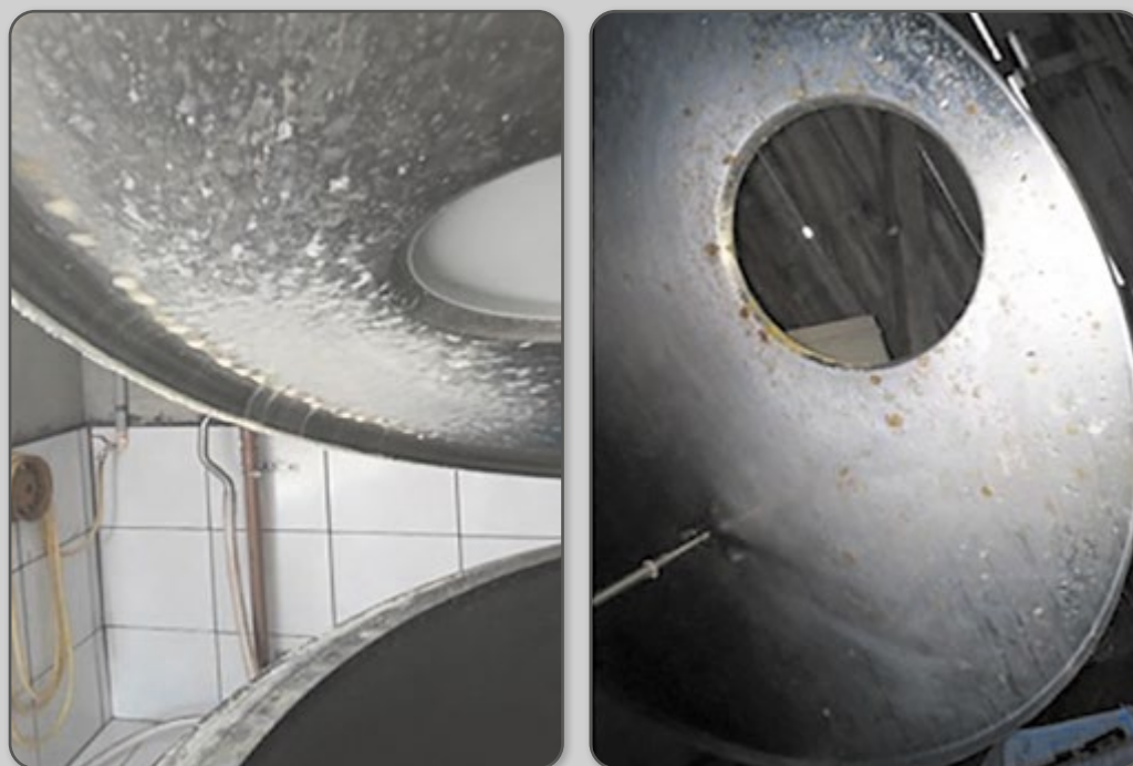
Figura 32 – Tampas de tanques de expansão em condições ruins de higiene.
