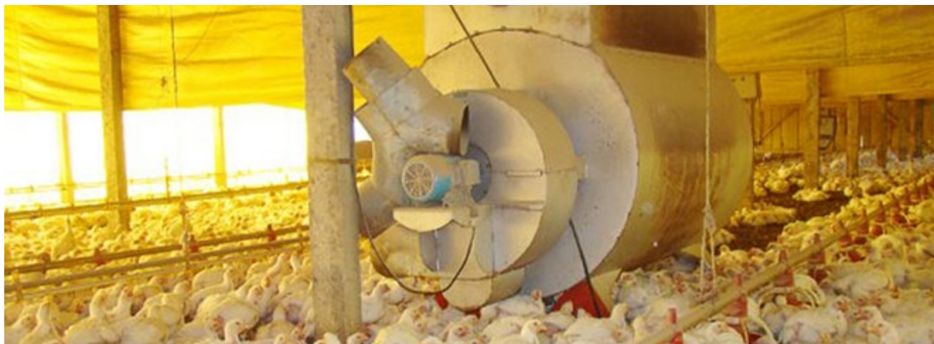
Um bom sistema de aquecimento é fundamental em aviários
